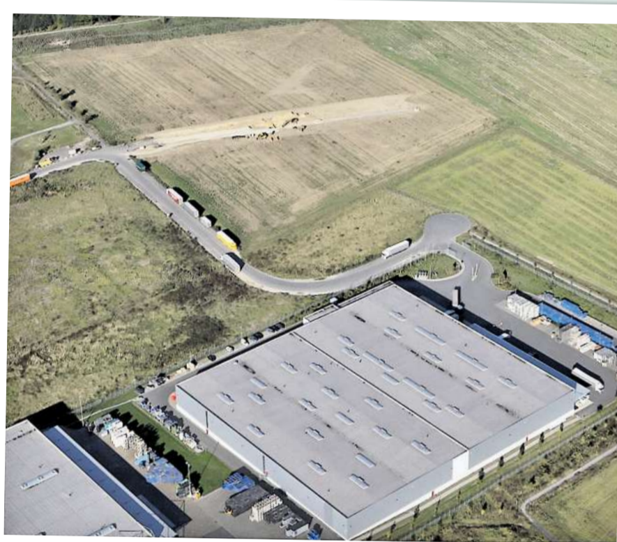
Baustelle Heinenkamp: Östlich der Straße Lehmkuhlenweg wird ein neues Grundstück erschlossen. Die Firma Ixocon will hier eine Logistikhalle bauen.
